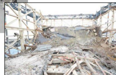
崩落屋根状況
