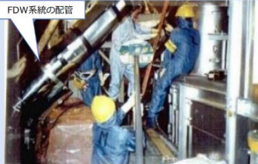
【震災前：定期検査時】FDWシステム配管 FDWシステムの配管
