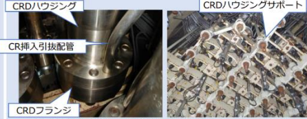
CRD関連機器(左：震災前：定期検査時、右：5号機)
