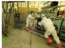
堆積物除去装置 (低圧水) 設置
