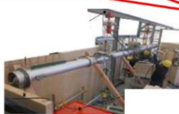
スプレー治具設置 ※X-53ペネに接続
