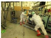
堆積物除去装置 (低圧水) 設置
