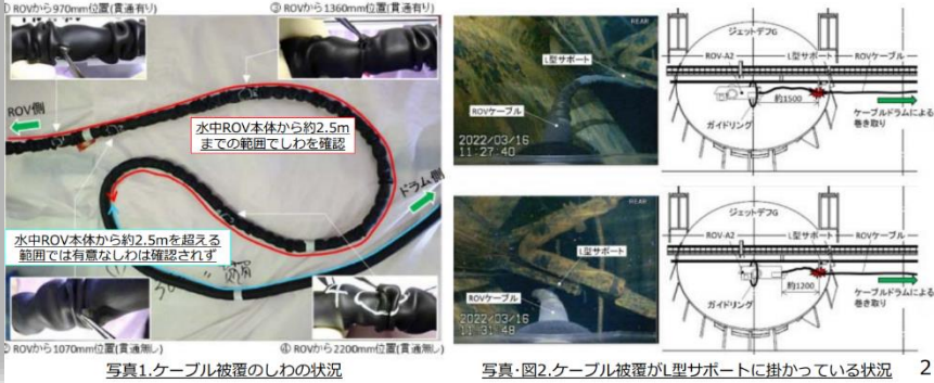
写真1.ケーブル被覆のしわの状況
