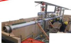
スプレー治具設置 ※X-53ペネに接続
