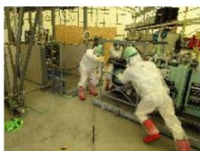
堆積物除去装置 (低圧水) 設置
