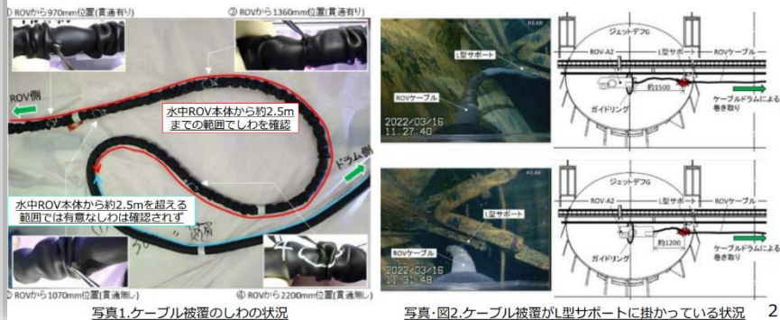
写真1.ケーブル被覆のしわの状況
