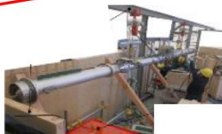
スプレー治具設置 ※X-53ペネに接続
