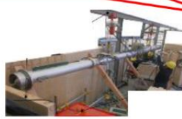
スプレー治具設置 ※X-53ペネに接続
