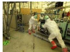
堆積物除去装置 (低圧水) 設置
