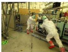
堆積物除去装置 (低圧水) 設置
