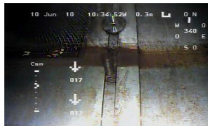
可動堰のボルトの様子（北西側の右下部分）
