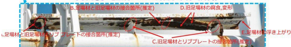
【写真③】足場落下箇所の西側隣接部
