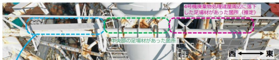
【写真①】地上約76mの南側水平材（再掲）
