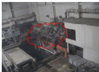
⑤干渉物撤去 (SFP南側既設設備撤去) ※4 ※4 撤去範囲と工法は検討中
