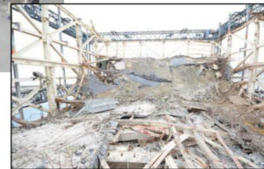
崩落屋根状況
